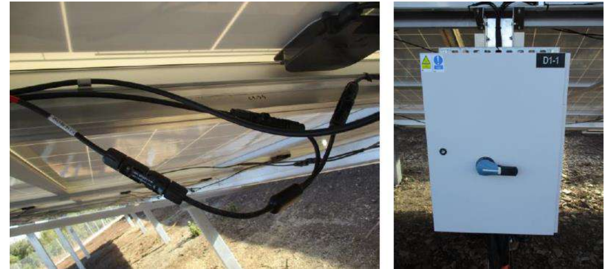
Photo 12. Exemple de câble électrique et de boîte de raccordement
